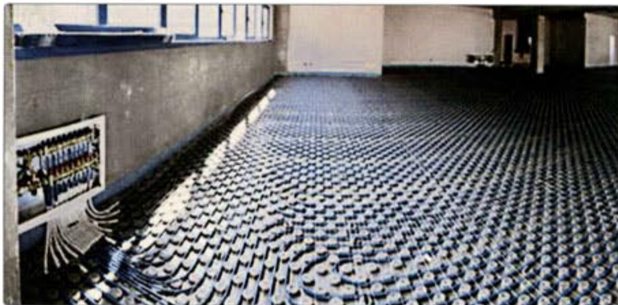
FIG. 3 Pavimento radiante (Rdz)
